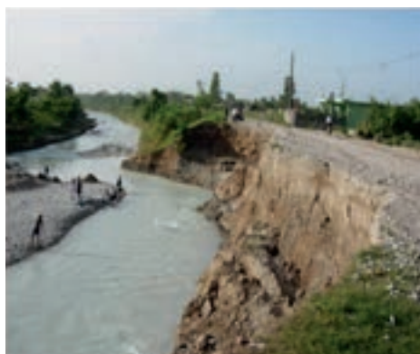
Réduction des risques à Pèlerin (Sud) : avant
